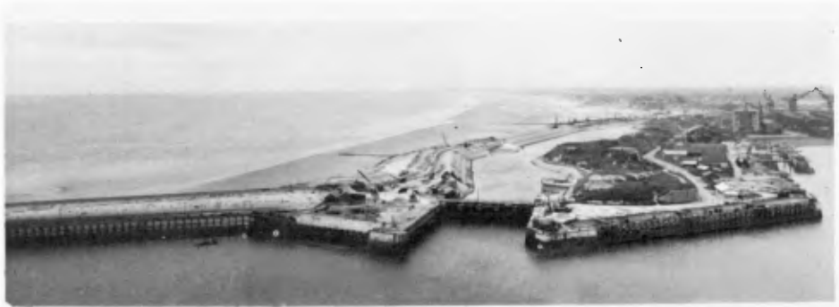
Fig. 31. Le chantier de reconstruction de la digue de l'Est en Juillet 1953 - Au centre de la digue, la partie reconstruite en 1949.
