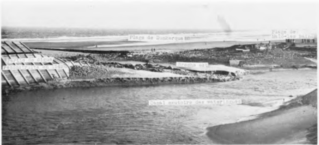
Fig. 9. La brèche est ouverte par la tempête du 1er Février 1953 - Vue prise à marée basse - A gauche les perrés côté canal de la partie de la digue reconstruite en 1949 - Au premier plan le canal exutoire des wateringues.
