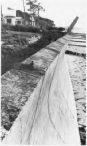
Photo No. 9 Bassin d'Arcachon. Perré en béton armé sans terrasse, déversé après le raz de marée du 29 Décembre 1951.
