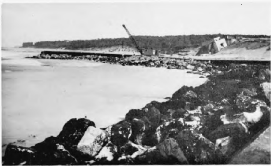
Photo N°8 - Pose d'enrochements devant le casier fermé de St Nicolas Arrivée du sable - décembre 1953
