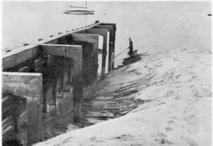
Photo No. 10 Bassin d'Arcachon Epi trop long à proximité du chenal du Moulleau
