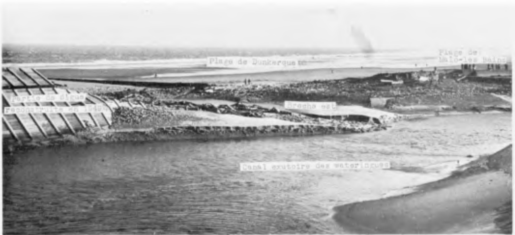
Fig. 9. La brèche est ouverte par la tempête du 1er Février 1953 - Vue prise à marée basse - A gauche les perrés côté canal de la partie de la digue reconstruite en 1949 - Au premier plan le canal exutoire des waterings.
